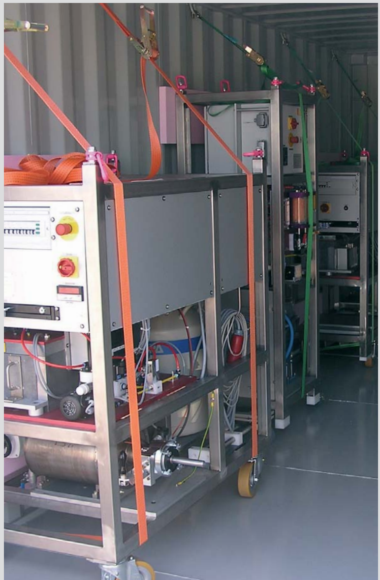
Anlage zur Überwachung der Trocknung von CASTOR®-Behältern (AirActivityMonitoring und Adapter-Sipping) – Auslieferung im IP2 Transport- und Lagerbehälter
